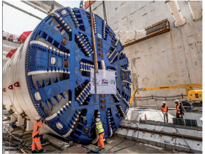
Copyright : Descente de la roue de coupe sur le chantier de la gare Créteil l'Échat : Société du Grand Paris / Axel Heise
